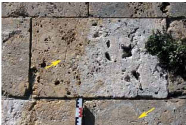
25 - Contrefort du clocher sud de la cathédrale d'Elne réalisé par G. Sagrera au début du XV e siècle avec ses ouvriers de Baixas. La cargneule blonde est visible sur le parement central à gauche avec un signe lapidaire. La partie de couleur grise pâle à violine, creusée de grosses cavités, est un calcaire (dolomitique ?) qui semble un peu bréchiq. Les signes lapidaires, tel celui du bas, en forme de Z, sont les mêmes que pour les brèches bleues du clocher de Baixas (XIV e siècle).
