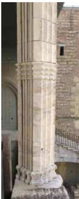
36 - Pilier conservé au sud de l'arcade du porche de la chapelle Sainte-Croix. Le marbre cipolin au grain plus fin est moins altéré que sur la façade, surtout à la base qui est sûrement d'origine.
