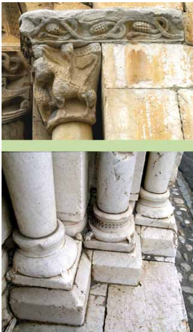
29 - Portail de l'église fortifiée d'Espira-de-l'Agly. En haut le marbre homogène légèrement bleuté à grisâtre du tailloir et des chapiteaux s'oppose à la blancheur des parements, cependant fissurés (filets rougeâtres typiques du marbre d'Estagel). En bas, base des belles colonnes monolithiques choisies parmi le marbre le plus homogène, légèrement gris : comparer avec la pierre du seuil qui est également taillée dans le même faciès, mais où le réseau de microfissures apparaît grâce à leur altération jaunâtre.
