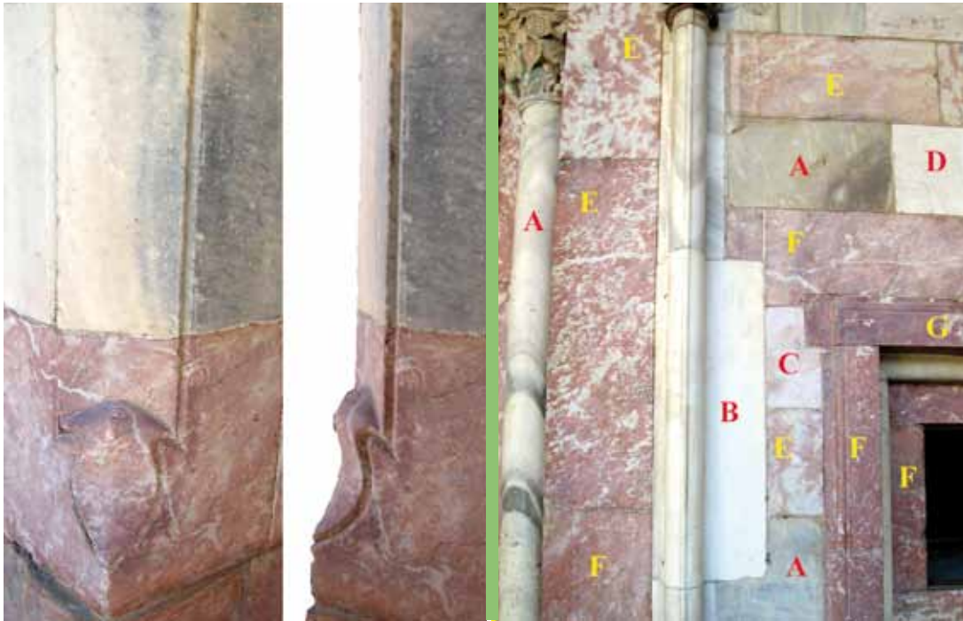
34 - Façade de la chapelle Sainte-Croix. À gauche, congé du chanfrein de face et de profil sur le mur de l'avancée nord. À droite, aspect des différents matériaux des assises « blanches » avec des marbres fini-précambriens très oxydés (A) ou au contraire très blancs à patine ivoire (B), mais aussi la « brèche romaine » (C) ou les marbres de type « Estagel » (D) de Baixas et, d'autre part, pour les assises rouges, avec les marbres « MFV » (E), plus ou moins chargés de blanc, parfois très compacts (F) ou de couleur pourpre, et étranger au substrat local (G).
