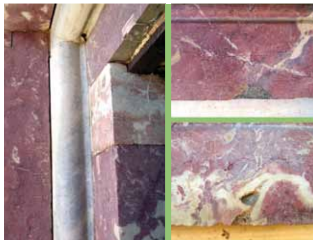
56 - Façade de la chapelle haute au château royal. À gauche, détail de l'angle supérieur gauche de la fenêtre nord. À droite, détails des sortes de géodes dans le marbre pourpre et différence des marbres blancs du tore (patine ivoire en bas).
